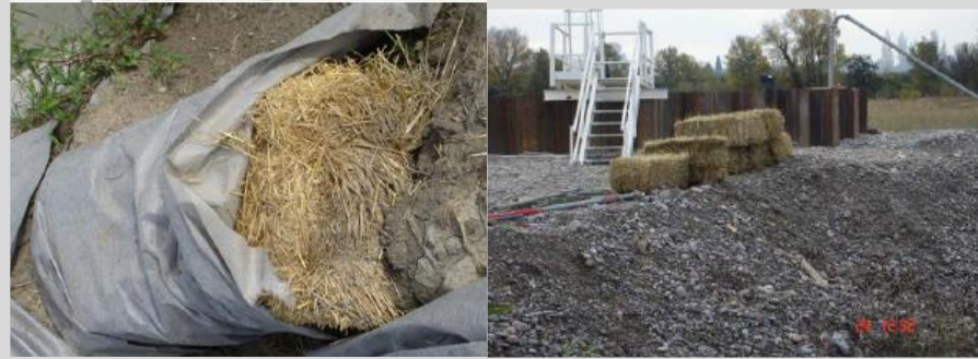
Figure 10 : Filtres à pailles (Source photo : CETE)
