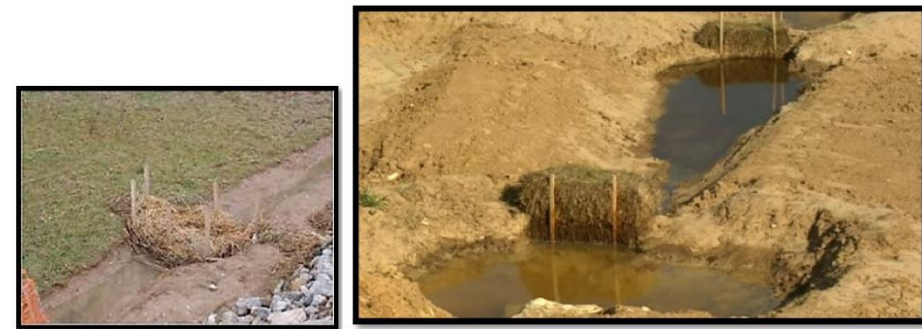
Filtre à paillet et bassin de décantation
