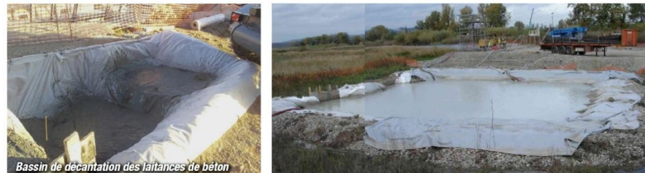
Bassin de décantation des laitances de béton
